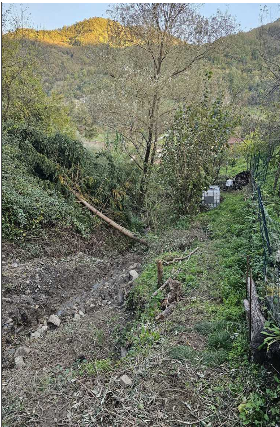
Foto 1. Franamento della ripa lungo fosso di Mozzacacio
