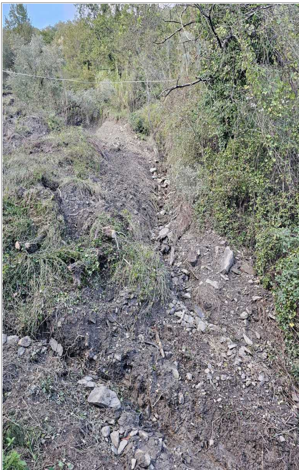
Foto 2. Franamento della ripa lungo fosso di Mozzacacio
