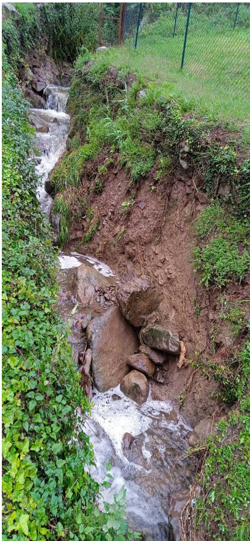
Foto 2. Franamento della ripa lungo fosso di Mozzacacio
